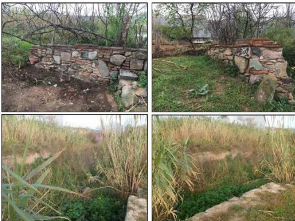
Fig. 18. Fotos superiors, vista del mur nord del pont de Santa Coloma, al febrer de 2021. Fotos inferiors, estat del Rec Comtal al mes de febrer de 2021. Font: Carles Navarro (2021).
